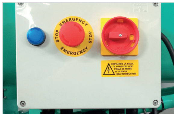
Quadro macchina monofase
