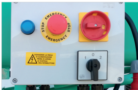
Quadro macchina trifase
