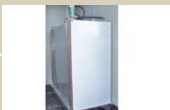
Serbatoio di capacità maggiorata separato dal gruppo elettrogeno
