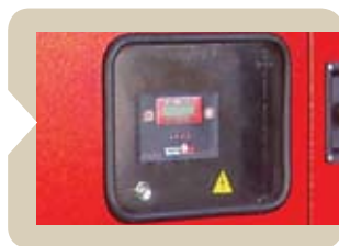
Finestra di visualizzazione del pannello di controllo per un più facile verifica dello status operativo del gruppo
