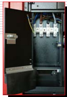
Morsettiera di potenza protetta da interruttore magnetotermico e differenziale 0,03 A (standard per potenze superiori a 40 kVA continui)
