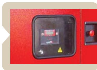
Finestra di visualizzazione del pannello di controllo per un più facile controllo dello status operativo del gruppo
