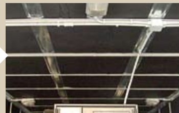
Impianto di illuminazione interna con interruttore
