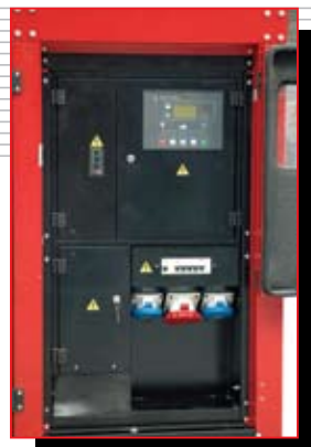
Quadro di distribuzione ACP 7310-01, completo di prese di tensione e morsettiera di potenza, protette da interruttori magnetotermici e differenziale 0,03 A
