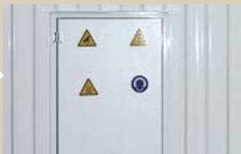
Ampio vano di accesso per la manutenzione del radiatore
