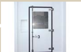
Vano quadro elettrico su lato corto con oblò in lexan
