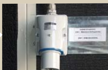
Presa di tensione 230 V installata all'interno del container
