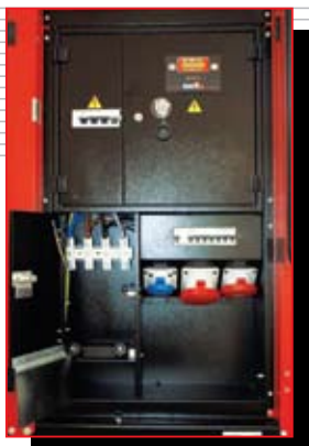
Quadro di distribuzione MCP 120-23, completo di prese di tensione e morsettiera di potenza, protette da interruttori magnetotermici e differenziale 0,03 A
